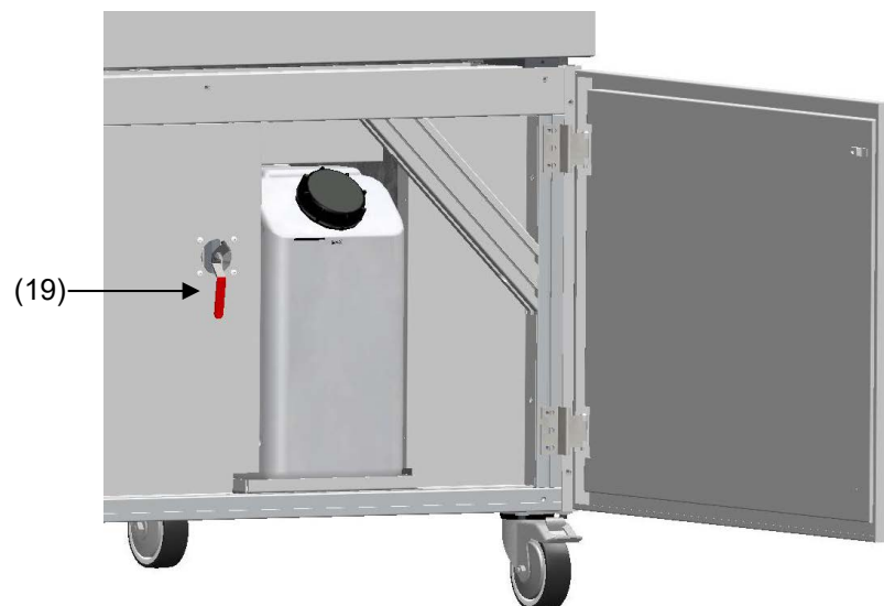
Figura 11: Manilla por la realimentación del condensado (posición abierta) junto al depósito de agua fresca detrás de la puerta de inspecciones
