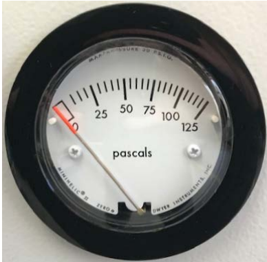
Abbildung 24: Analoge Druckanzeige (Manometer) zur Überwachung der Druckluftspülung an der Gerätefront
