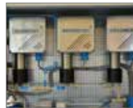
Die Prüfraumatmosphäre wird auf CO, H 2 und O 2 detektiert und überwacht
