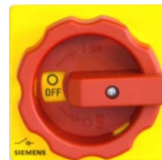
Abbildung 11: Hauptschalter der Gasdetektionsanlage (10) (Position OFF)
